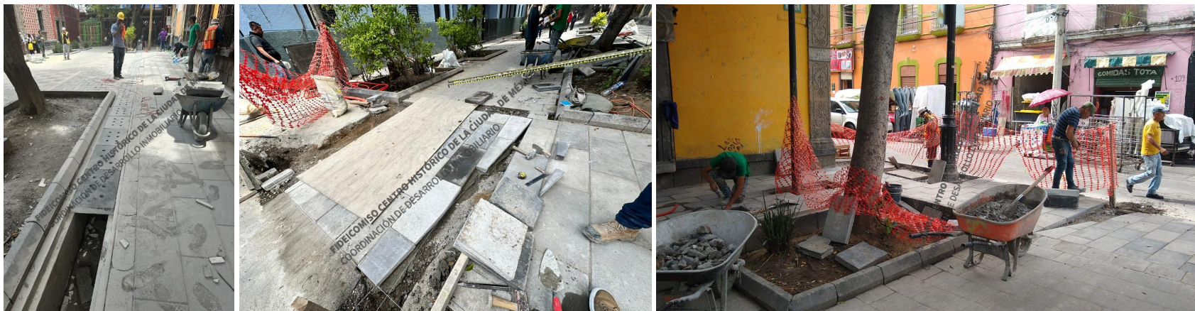
Colocación de tapas de dren de captación pluvial, elaboración de rampa en acceso al callejón y colocación de adocreto en banquetas.
