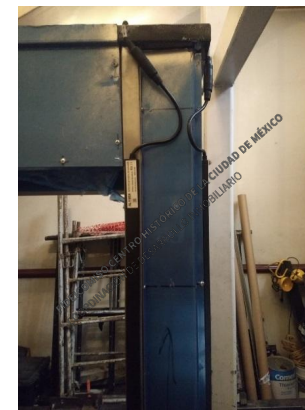
Sistema hidráulico para funcionamiento de pistones del sistema de elevador.
