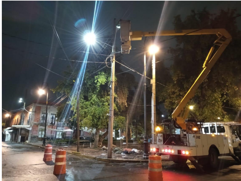
RECONEXIÓN DE LÍNEAS DE ALIMENTACIÓN
