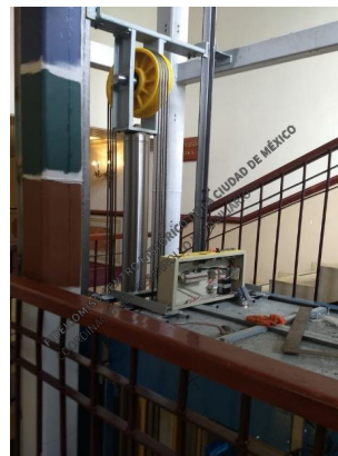
Sistema central del elevador
