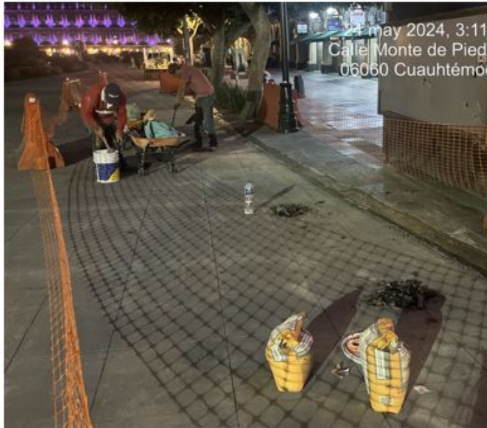
UBICACIÓN: TRAMO NORPONIENTE, ZÓCALO, CIUDAD DE MÉXICO. (TERMINAN TRABAJOS DE COLADO DE GROUT ENTRE DREN Y GUARNICIÓN)
