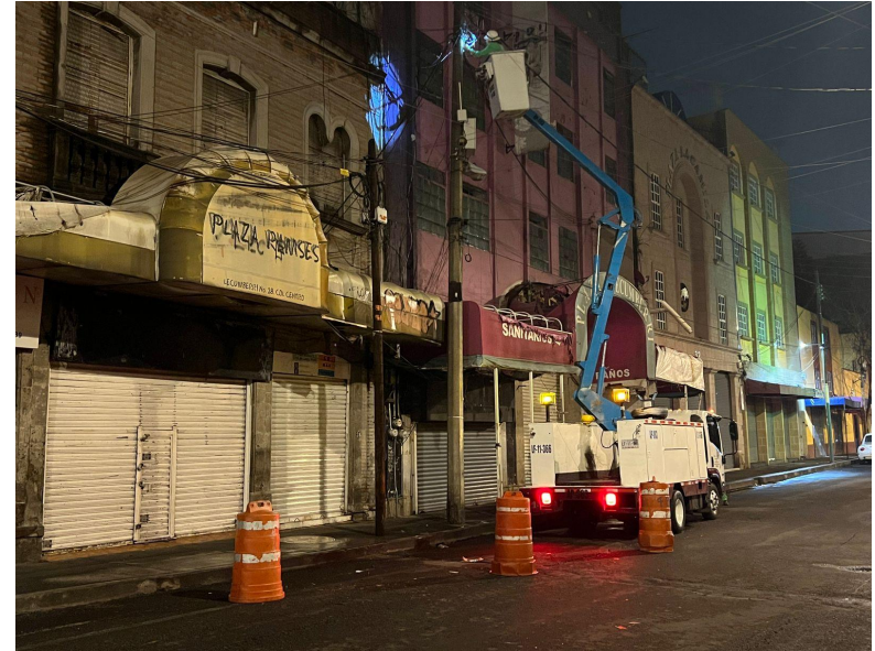
RECONEXIÓN DE LÍNEAS DE ALIMENTACIÓN
