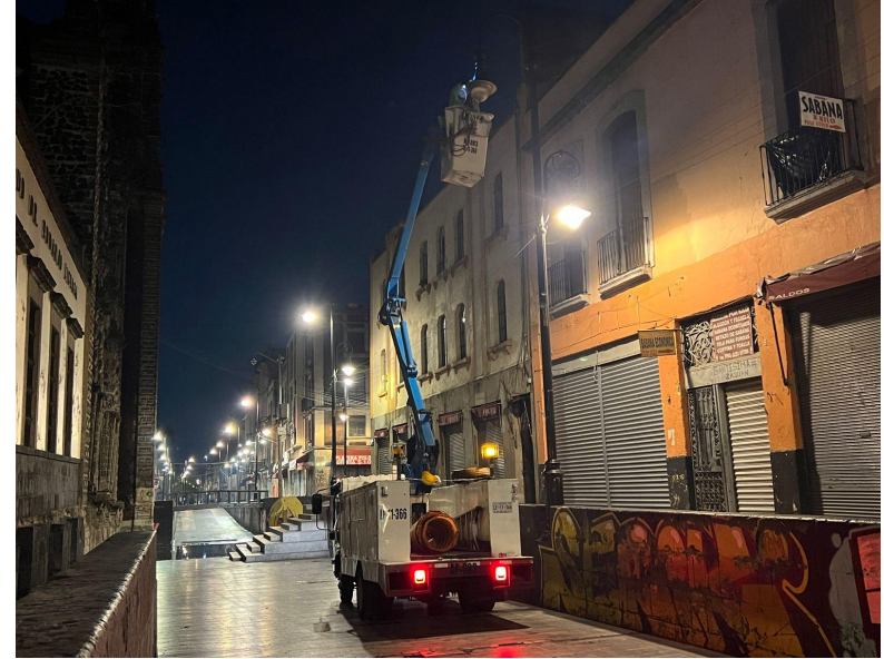
RECONEXIÓN DE LÍNEAS DE ALIMENTACIÓN
