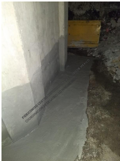
Construcción de chaflán y próxima aplicación de impermeabilizante para evitar filtraciones al cubo del elevador.
