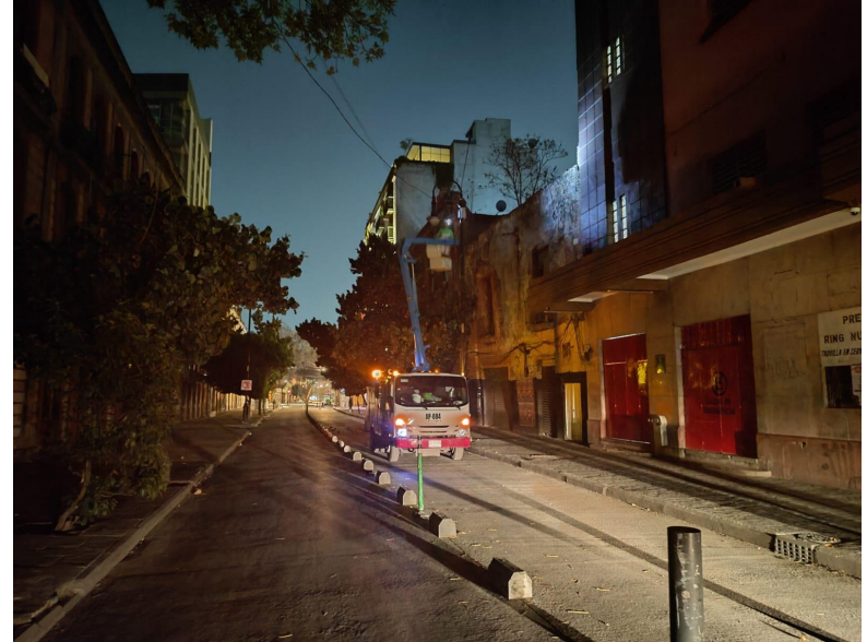
RECONEXIÓN DE LÍNEAS DE ALIMENTACIÓN
