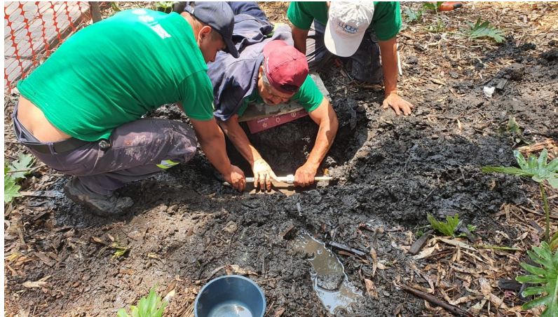
Se realizó reparación de una fuga de agua en San Jerónimo, 26 de mayo de 2023
