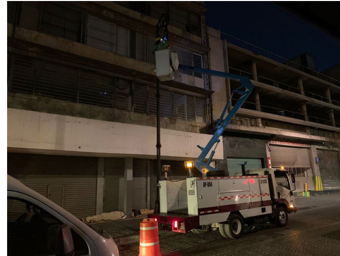
CAMBIO DE BALASTRO
