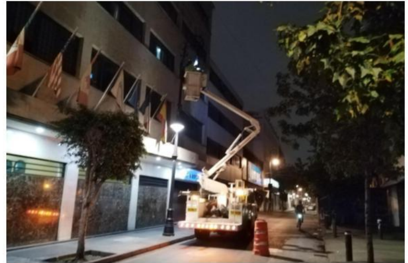
CAMBIO DE BALASTRO ELECTRÓNICO
