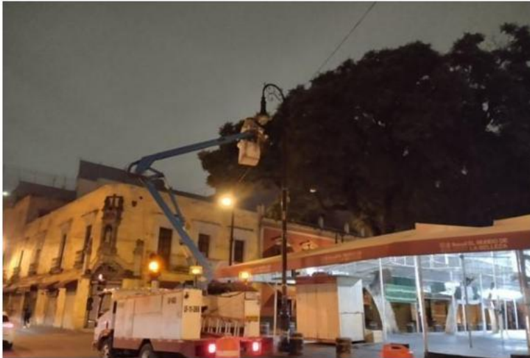
CAMBIO DE BALASTRO ELECTRÓNICO
