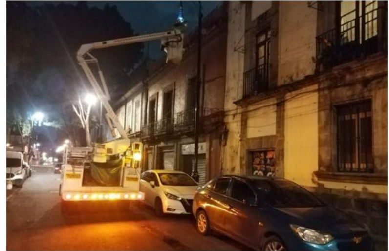
SUSTITUCIÓN DE BALASTRO ELECTRÓNICO
