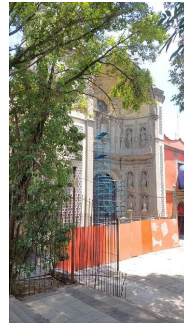
Movimiento de tapial y armado de tapial en fachada principal del templo para atención a grietas.
