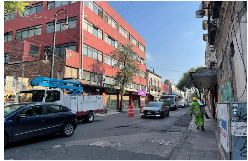
CAMBIO DE FOTOCELDA
