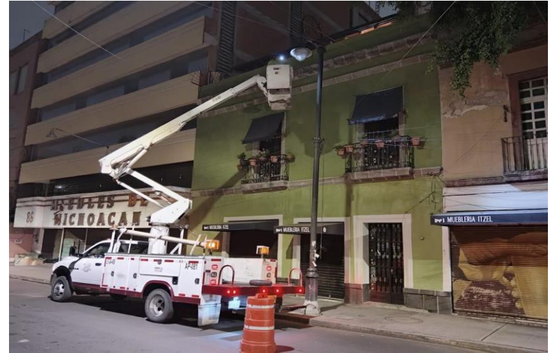
CAMBIO DE BALASTRO ELECTRÓNICO
