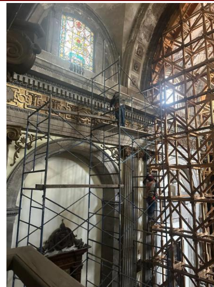
Atención a grietas al interior del templo, iniciando por el retiro de aplanados.
