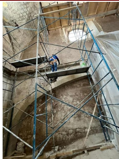
Atención de grietas al interior del muro de la fachada principal, a nivel de coro.
