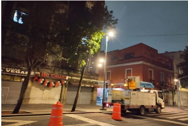
RECONEXIÓN DE LÍNEAS DE ALIMENTACIÓN
