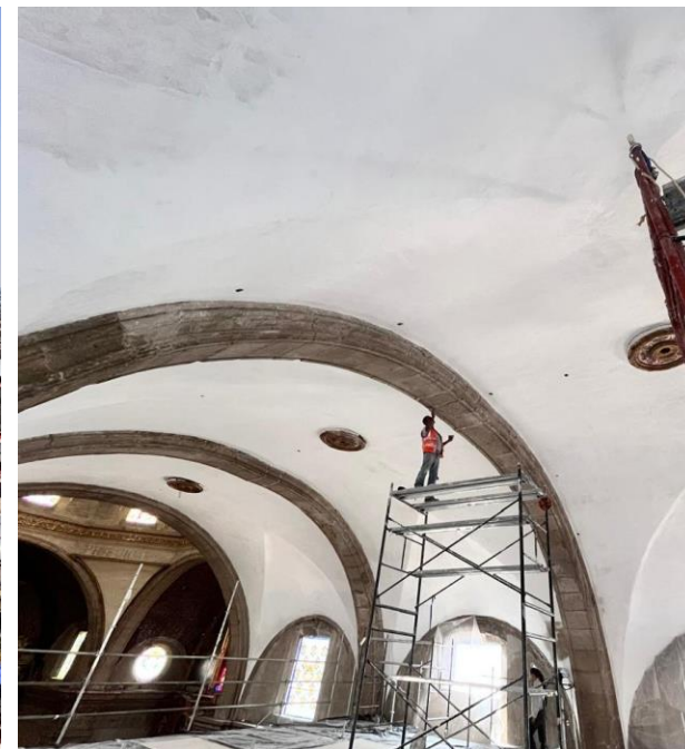
Atención a grietas en intradós de bóvedas de nave principal aplicación de aplanado fino y pintura a la cal
