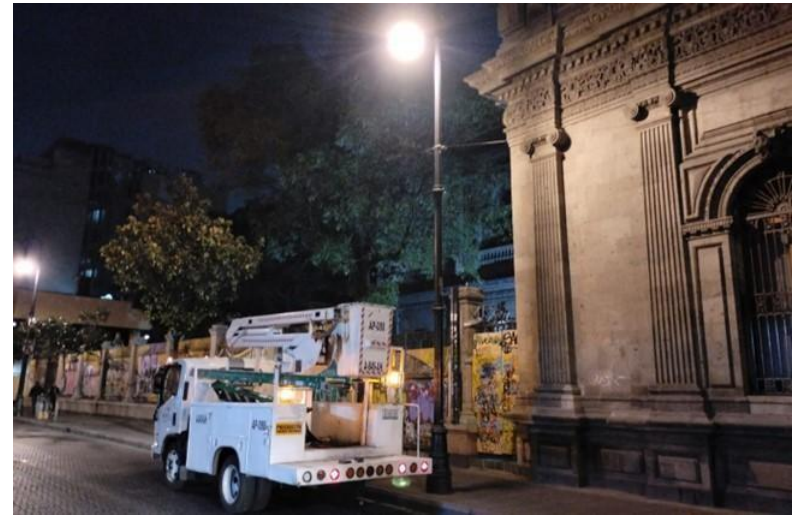
RECONEXIÓN DE LÍNEAS DE ALIMENTACIÓN
