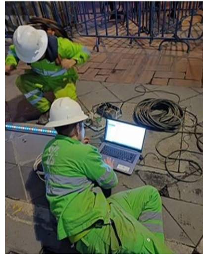
REEMPLAZO DE 16 PROYECTORES
