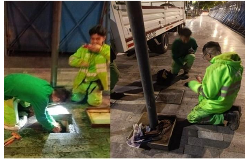
CORRECCIÓN DE CABLES CORTADOS
