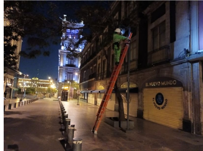
RECONEXIÓN DE LÍNEAS DE ALIMENTACIÓN
