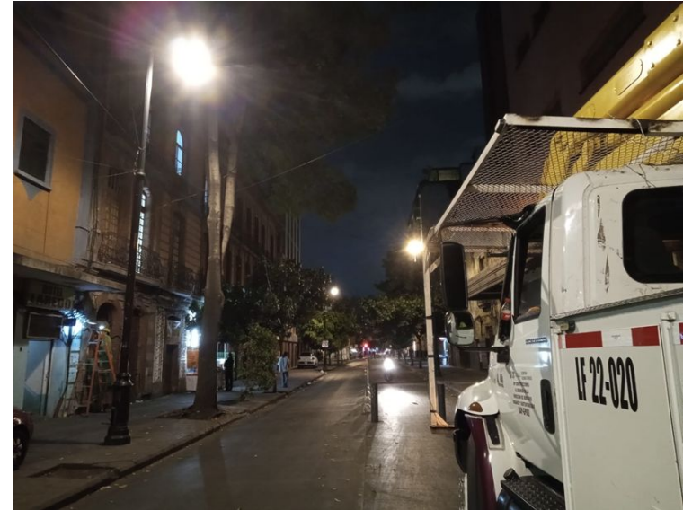
RECONEXIÓN DE LÍNEAS DE ALIMENTACIÓN
