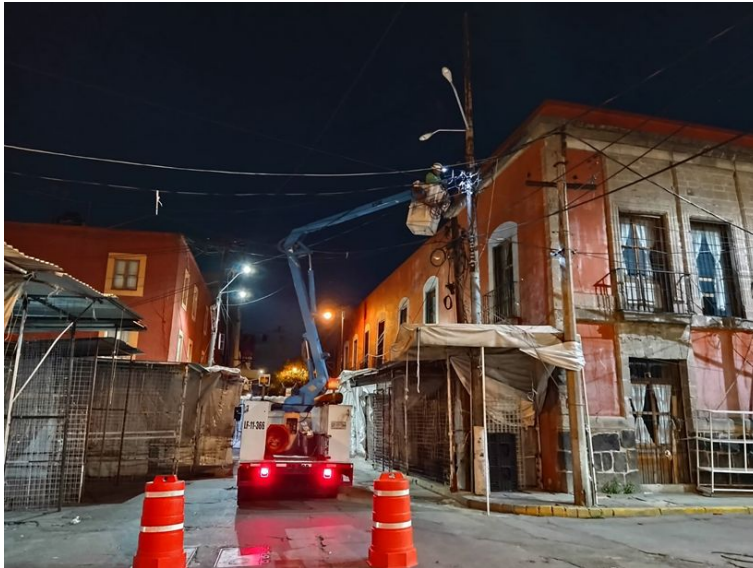
RECONEXIÓN DE LÍNEAS DE ALIMENTACIÓN
