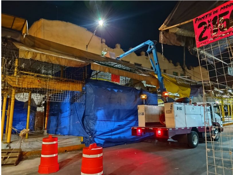
RECONEXIÓN DE LÍNEAS DE ALIMENTACIÓN
