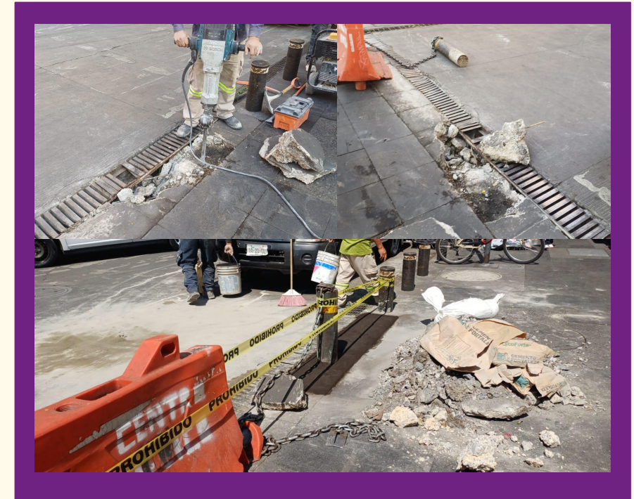
Retiro de rejilla Irving y colado Calle Republica Argentina esq con calle San ildefonso.
