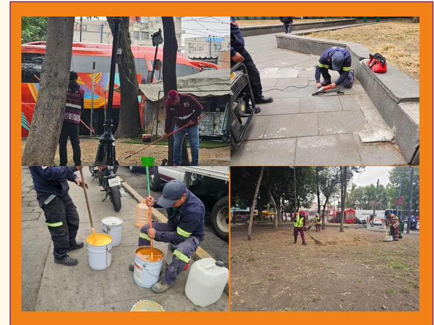
Realizar trabajos de mantenimiento, conservación y mejora en Parque de la Soledad Calle Emiliano Zapata entre calle Rosario y calle Santa Escuela.
