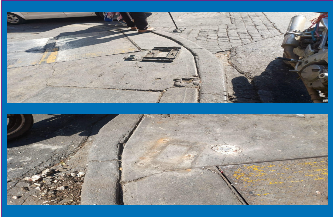
Retiro de base de caseta telefónica Calle Jesus Maria esquina con Av. San Pablo
