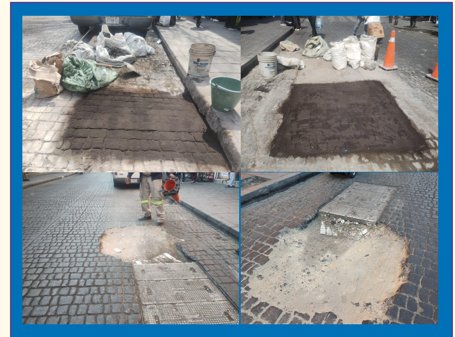
Reparación de baches Calle del Carmen #24 a la altura de calle San Ildefonso
