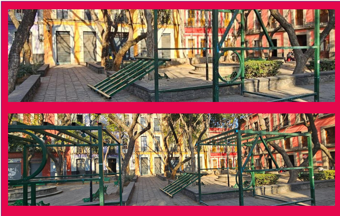
Retiro de estructura metálica. Plaza Santa Catarina (Calle República de Brasil esquina con calle República de Honduras)
