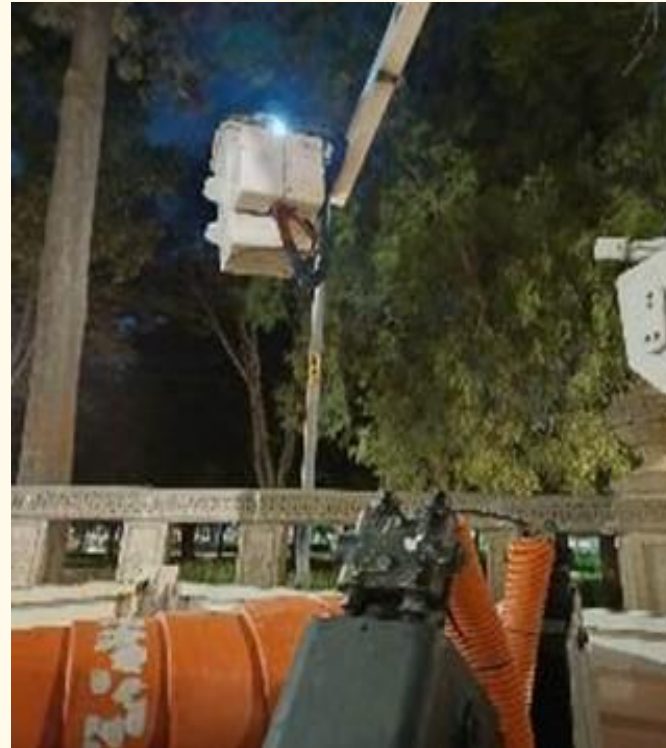
CAMBIO DE BALASTRO
