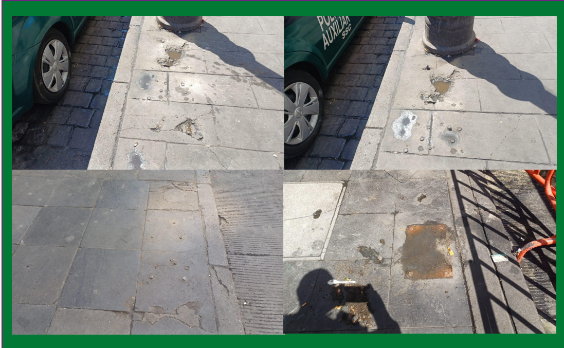
Retiro de pernos o espárragos expuestos Calle Madero esquina con calle Palma
