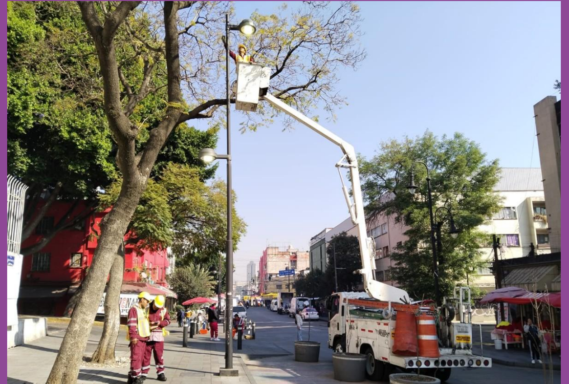
RECONEXIÓN DE LÍNEAS DE ALIMENTACIÓN
