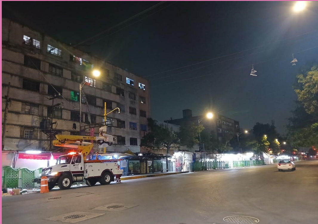
RECONEXIÓN A LÍNEAS DE ALIMENTACIÓN
