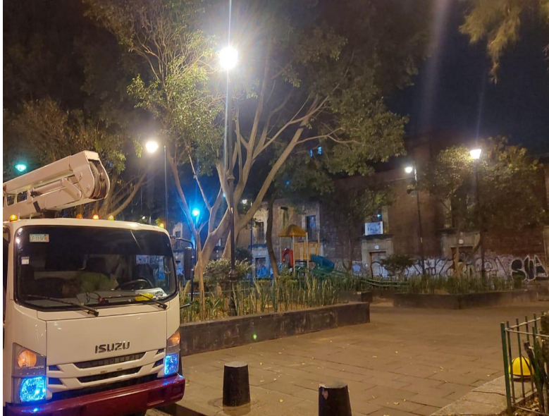
CAMBIO DE LÁMPARA, BALASTRO Y SOCKET
